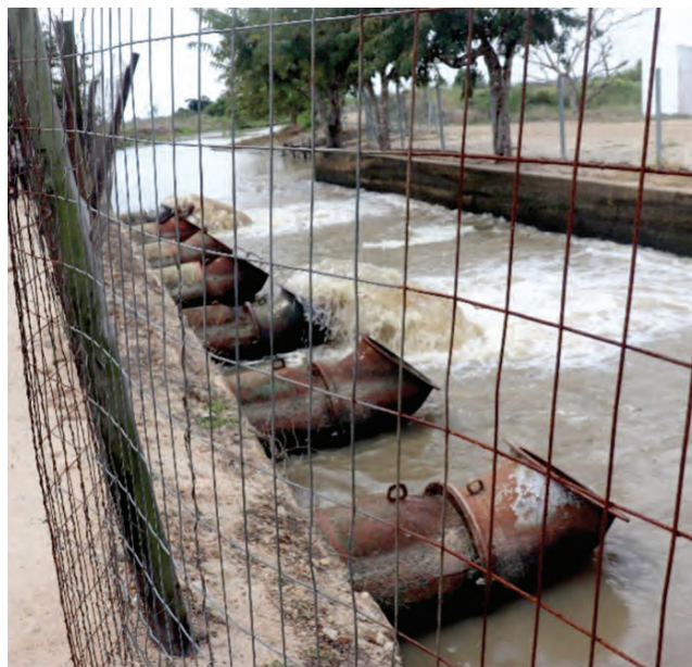
Captação de água para irrigação ao longo do rio Pungwe em Moçambique, interceptando o fluxo de água.
