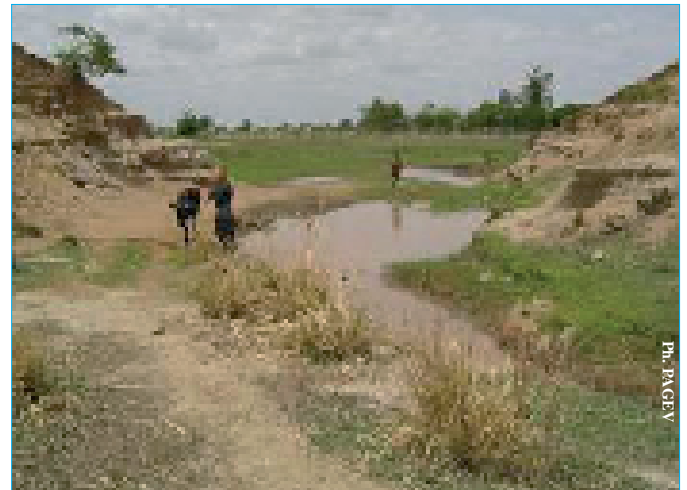
Figure 5 Barrage de Sakom avant la réhabilitation
