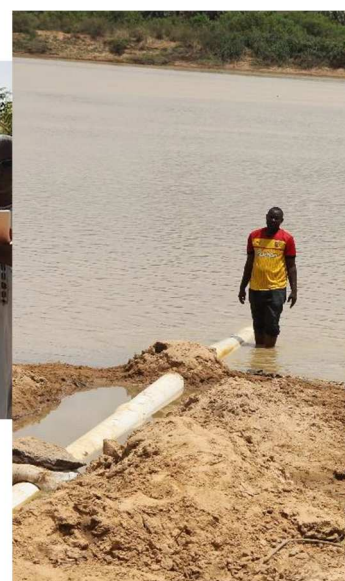
Prise d'eau station de pompage périmètre irrigué réhabilité de Boumba (Commune de Falmey)
