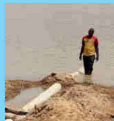
Prise d'eau station de pompage périmètre irrigué réhabilité de Boumba (Commune de Falme)
