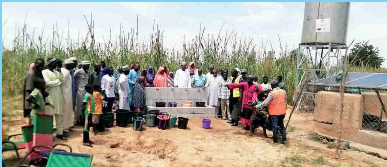
Poste d'Eau Autonome de Sénokonkedji (Commune de Tamou)
